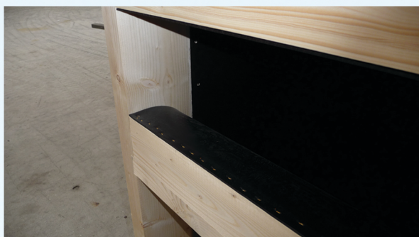
Afgeronde uitblaasopening in een 1-laagsventilatiesysteem
