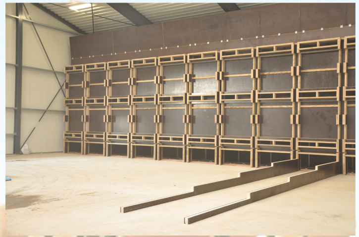
2-Laagsventilatiesysteem waarbij drogen op slossen ook mogelijk is.
